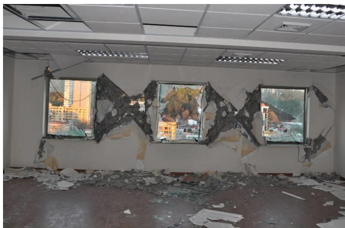
圖 4.26 RC牆大量開窗與開門造成明顯剪力破壞[4.22]
